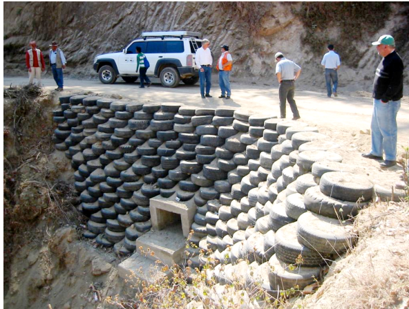
Foto 5, Muro de llantas para protección de camino rural en San Marcos, Guatemala
